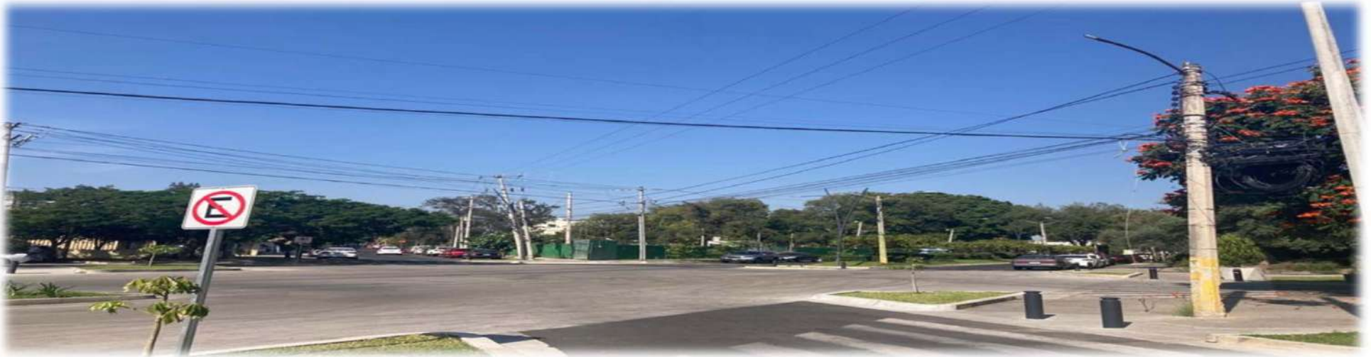
Cableado aéreo cruce Diag. Golfo de Cortes y Tarascos
