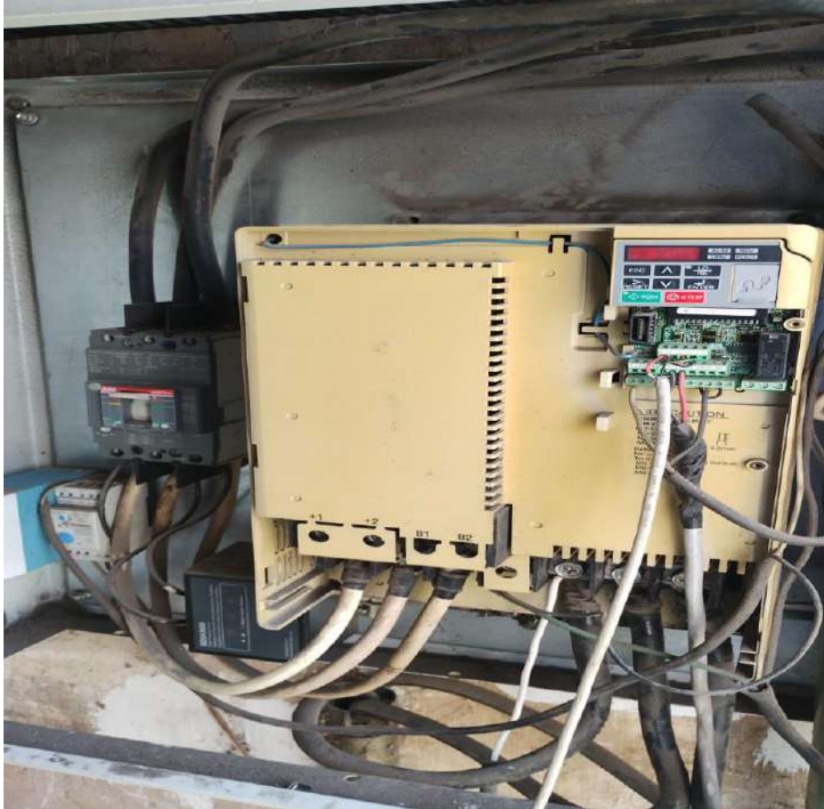
Anterior Variador De Potencia Pozo Toltecas De 15hp, El Cual Se Calentaba Y Se Apagada, Falla De Uso.
