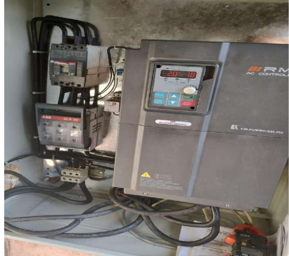
Nuevo Variador De Potencia Pozo Toltecas De 20hp Con Tren Sensor De Presión con Tanque Precargado y Manómetro Para Monitoreo De Presión.
